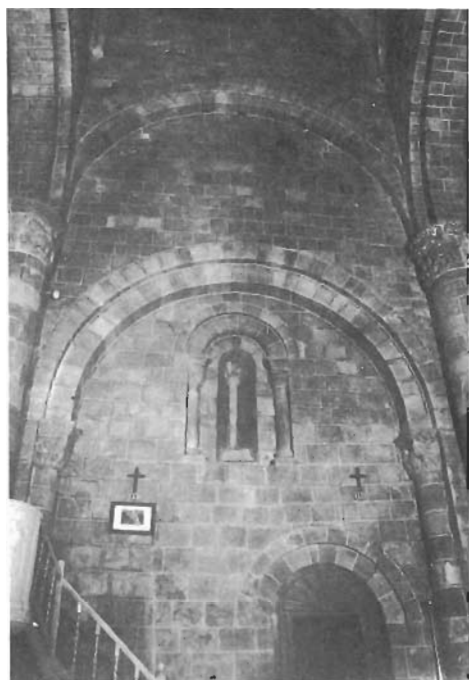
Degradación de muro. Puerta original. N.º 27
