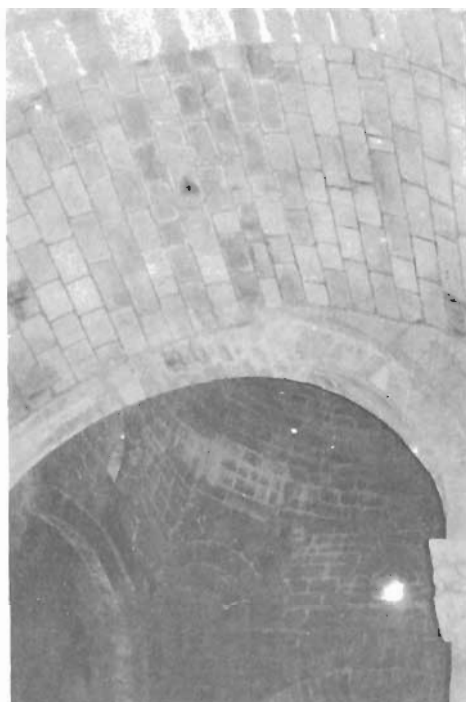
Crucero nave. Interior. Desvio de encaje de obra. N.º 3
